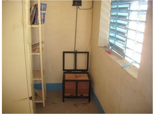
Régulateur et coffret batterie
