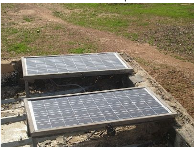
Plaques solaires installées
