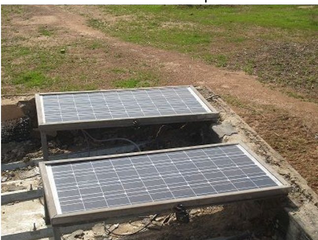
Plaques solaires installées
