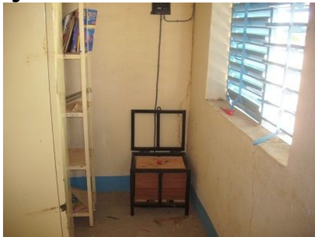
Régulateur et coffret batterie
