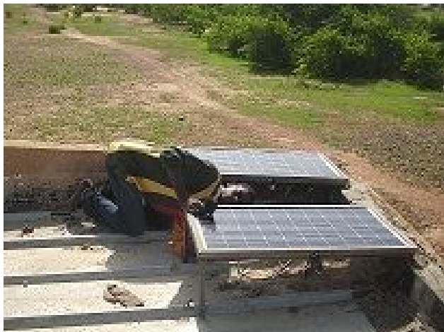
Branchement plaques solaires
