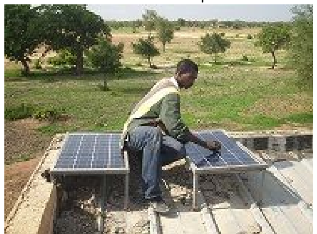
Nettoyage de plaques solaires
